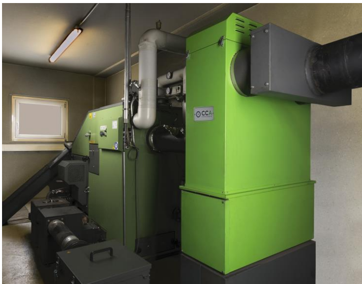
Der CCA-Abscheider (hellgrün) entfernt effektiv Feinstaub aus dem Rauchgas von holzbeheizten Kesselanlagen. (Bild: KIT/P. Langer)
