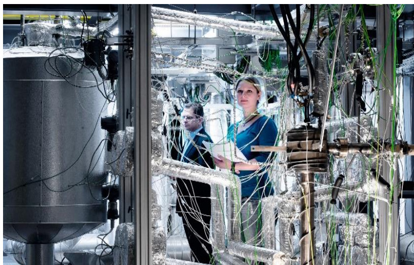
Versuchsanlage für Flüssigmetalle am KIT. Flüssige Metalle eignen sich gut zur Übertragung hoher Wärmeleistungen und im Rahmen von NADINE soll ihr Einsatz in thermischen Energiespeichern erforscht werden. (Foto: Karsten Litfin/KIT)
