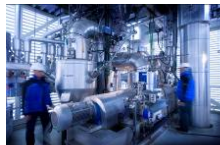
Blick ins Innere der bioliq ® -Anlage (Foto: Markus Breig)
