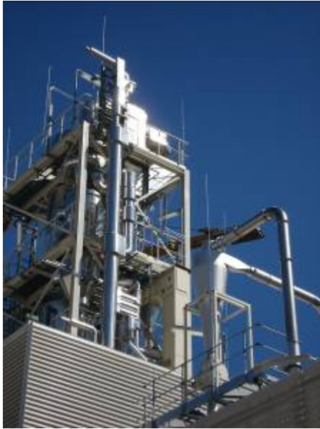
Schnellpyrolyse in der bioliq ® -Anlage. Hier wird Biomasse zunächst in ein flüssiges, transportfähiges Zwischenprodukt umgewandelt. (Foto: Markus Breig)
