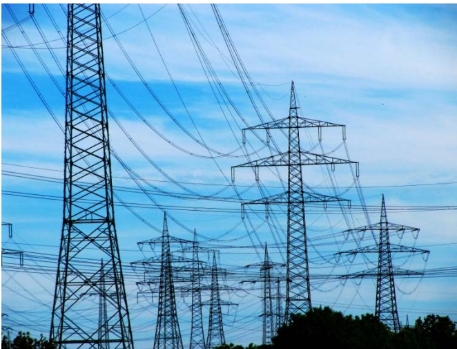
Stromnetze: Die Energiewende erfordert neue Technologien für eine sichere Versorgung. (Foto: Rainer Sturm/pixelio.de)
